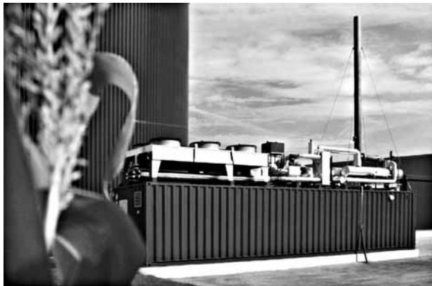
Контейнерная электростанция «Pro2» с двигателем Deutz TCG 2016 V12, работающим на биогазе
