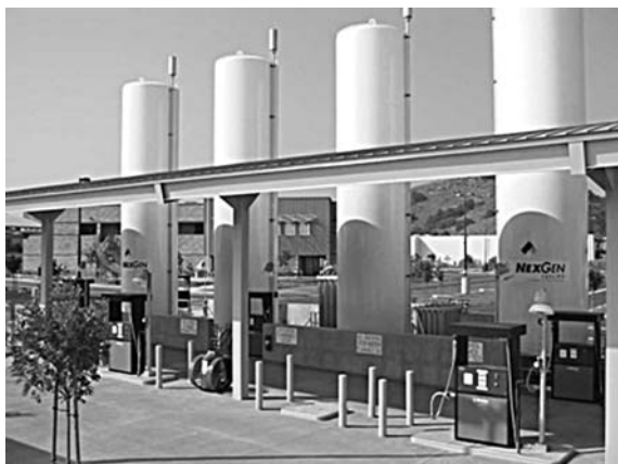
Рис. 3. Заправочная станция СПГ в Калифорнии
