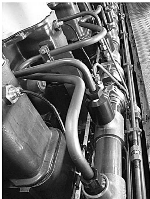
Рис. 3. Трубки высокого давления, соединяющие коллекторы с форсунками и друг с другом
