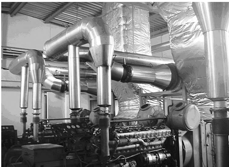
Рис. 4. Внешний вид машинного зала ЭТС
