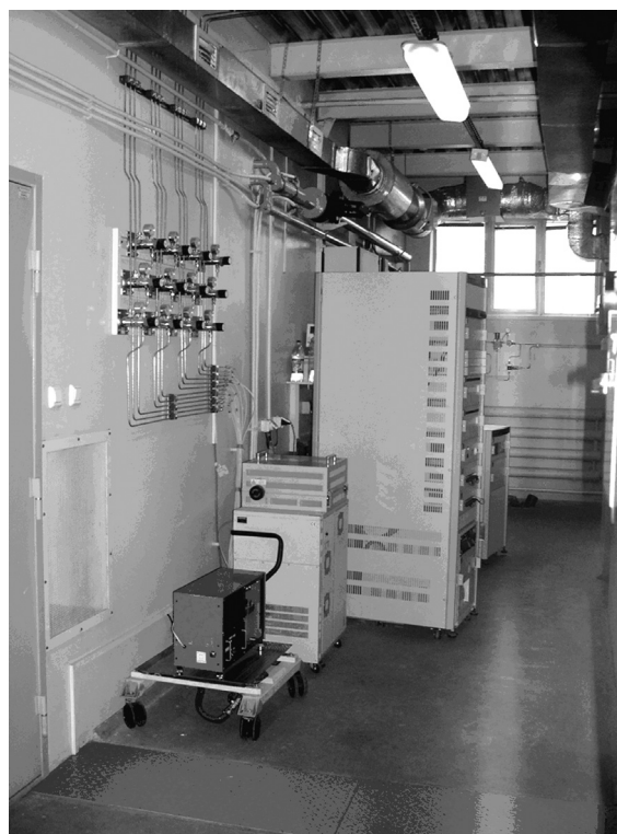
Рис. 4. Общий вид установки газоанализатора фирмы «Hogiba» в отдельном помещении
