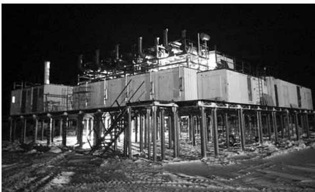
Рис. 2. Дизельная теплоэлектростанция мощностью 2,5 МВт
