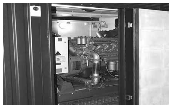
Рис. 3. Электроагрегат АД 200 в контейнерном исполнении типа «Север»
