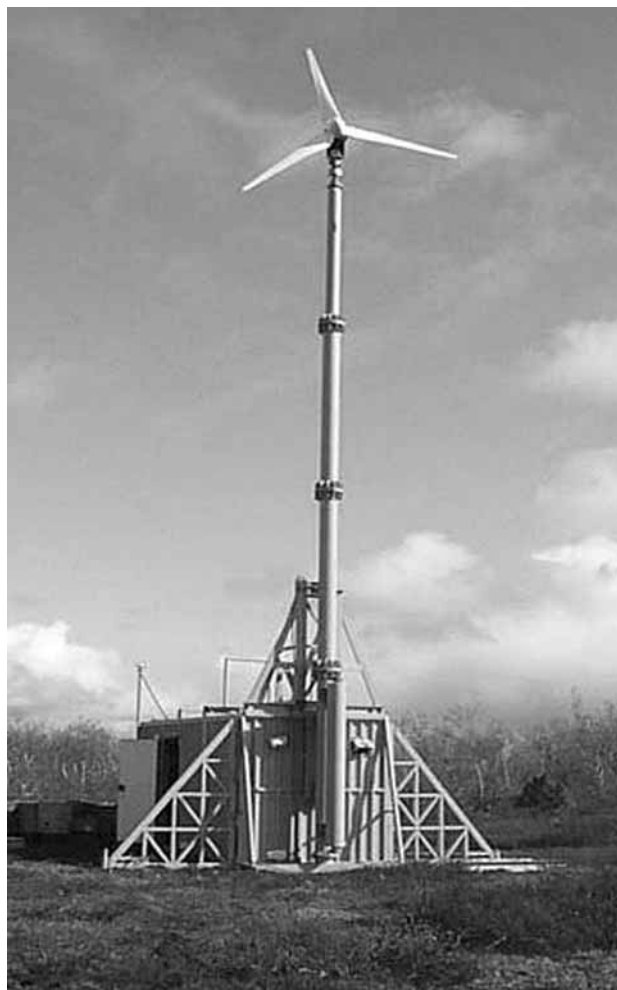
Комбинированная мобильная электростанция инновационного проекта ГБТЭС-2 «Тундра»
