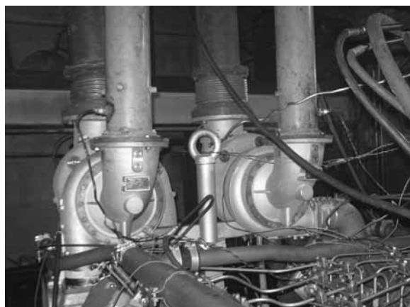
Рис. 1. Установка дизеля 8ДМ-21ЭЛ2М с турбокомпрессорами TCR14 на испытательном стенде ООО «УДМЗ»
