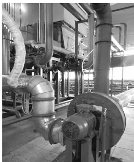
Рис. 4. Узел смешения отработавших газов дизель-генератора с воздуховодом подачи воздуха в котел
