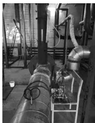
Рис. 3. Приборы измерения расхода и давления воздуха и газов рециркуляции
