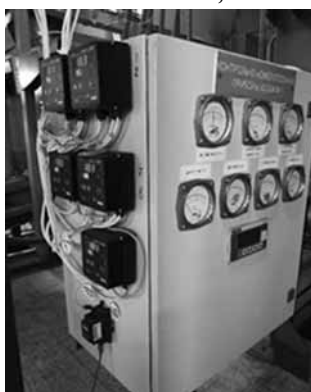
Рис. 5. Щит КИП с терморегуляторами
