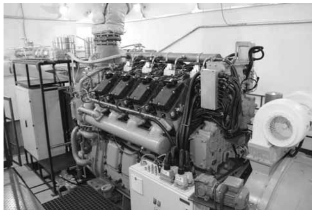
Рис. 1. Газовый двигатель-генератор 9ГМГ
