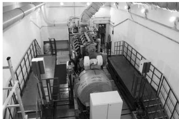
Рис. 3. Испытательный стенд с установленным газовым двигатель-генератором
